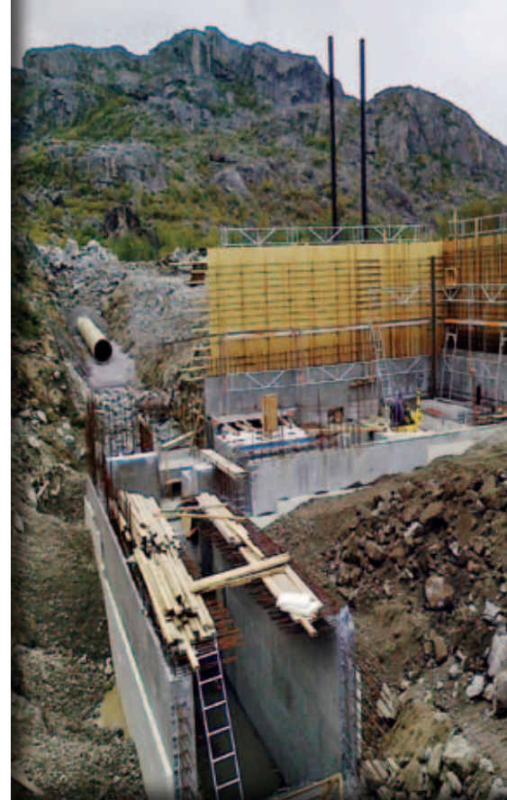
Valvatn kraftverk. FOTO: TROND AARSETH
